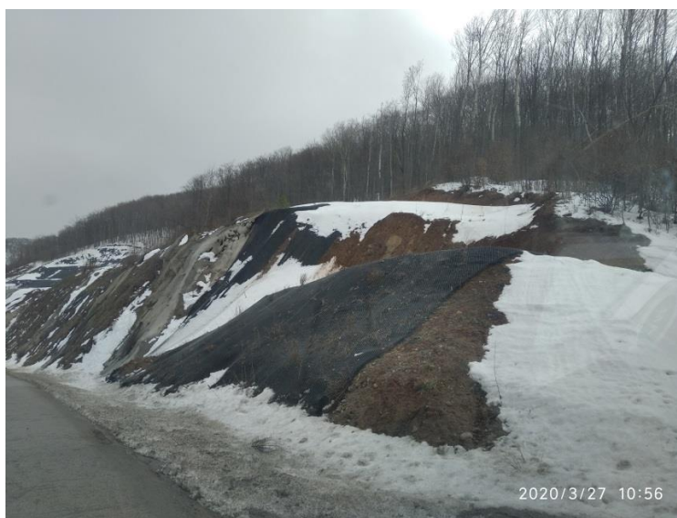
Фиг. 2 Свлачището при тунел Голямо Бучино km 10 (Landslide at the Tunnel Malo Buchino)
