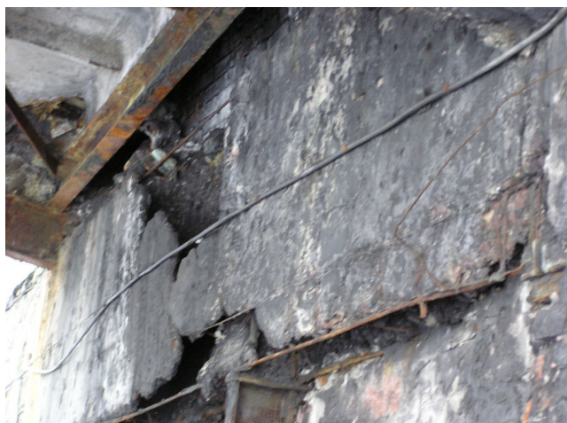
Рисунок 3. – Разрушение стеновой панели
